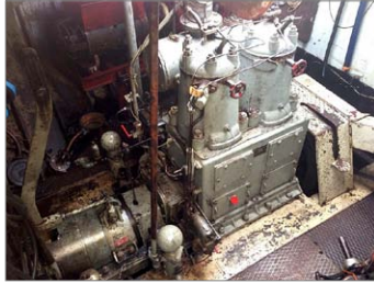
Rennes 2DC in de machinekamer van de Bregetta
